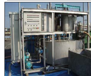
微生物製剤+栄養剤混合装置
